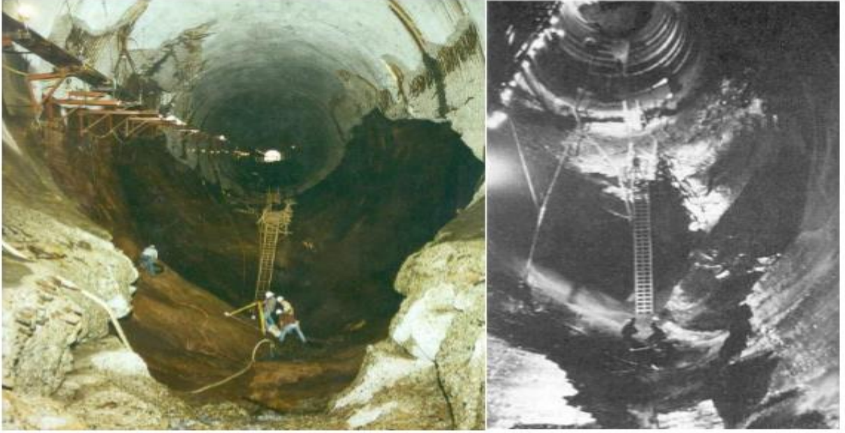
Şekil 1.2. Glen Kanyon Barajının (ABD) tünel dolusavağının kavitasyon hasarı (Falvey, 1990)
