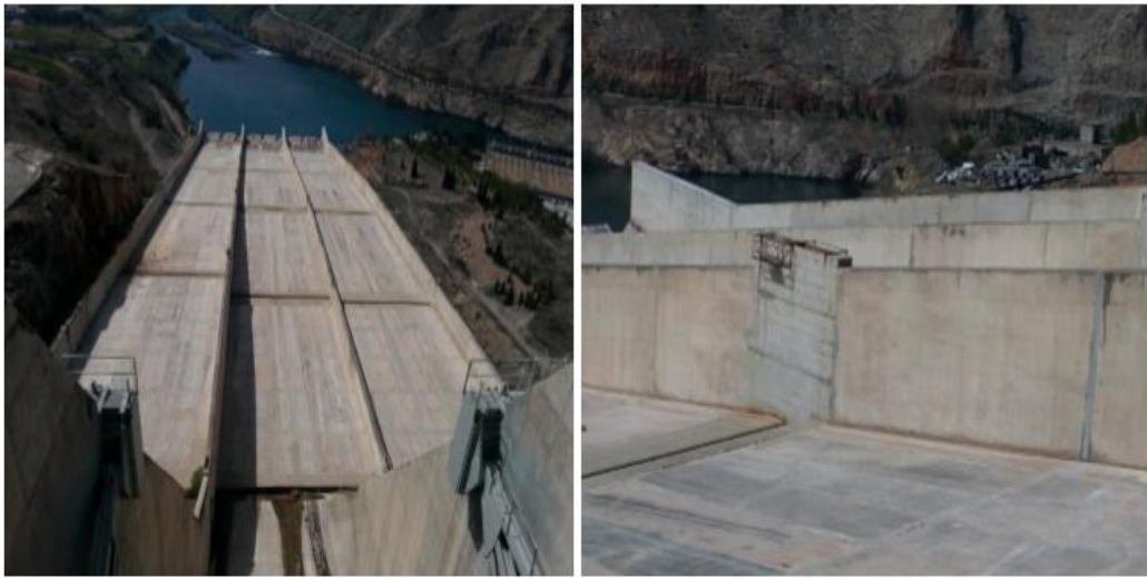
Şekil 1.3. Keban Barajında sonradan yapılan havalandırıcılar (Abbsoğlu ve Okay, 1992)
