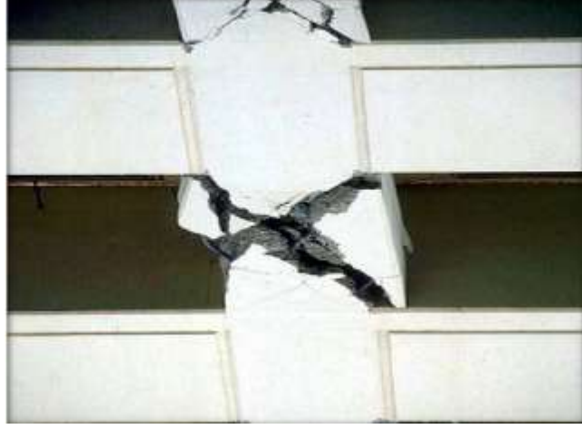
Şekil 2. 13. Parapet duvarlar nedeni ile oluşan kısa kolon hasarı (Demir, 2013)
