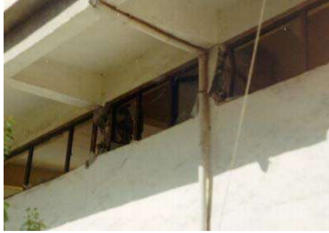
Şekil 2. 10. 1999 Gölcük depremi sonrası kısa kolon hasarı (Çağatay,2007)
