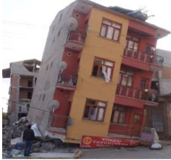
Şekil 2. 14. 2011 Van depreminde oluşan yumuşak kat hasarı (İnel vd., 2013)
