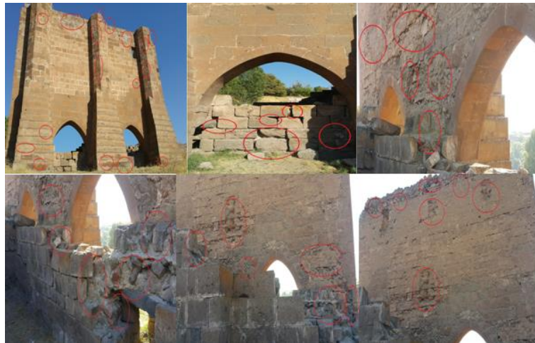
Şekil 4.30. İmarethane duvarında gözlemlenen hasarlar
