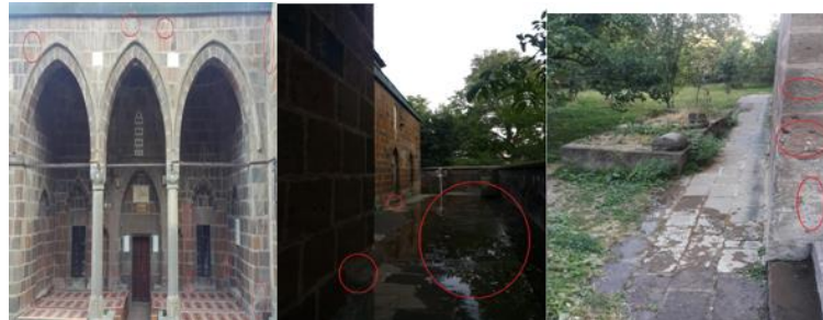
Şekil 4.11. Kadı Mahmut Camiinde gözlemlenen hasarlar
