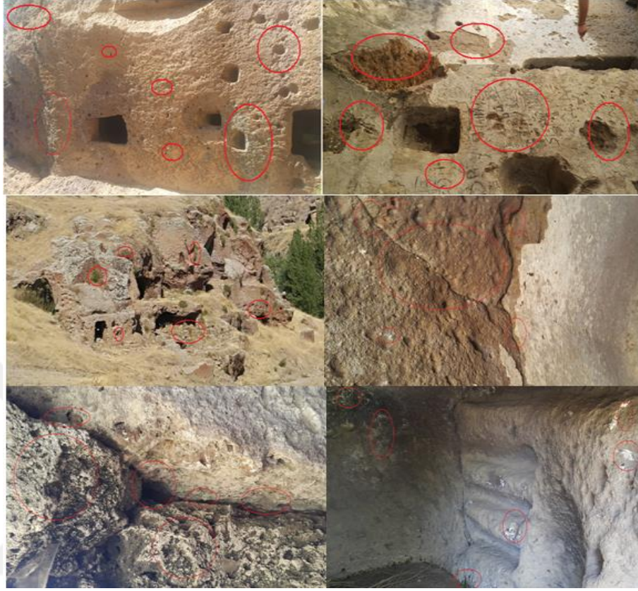
Şekil 4.8. Madavans mağara evlerinde gözlemlenen hasarlar
