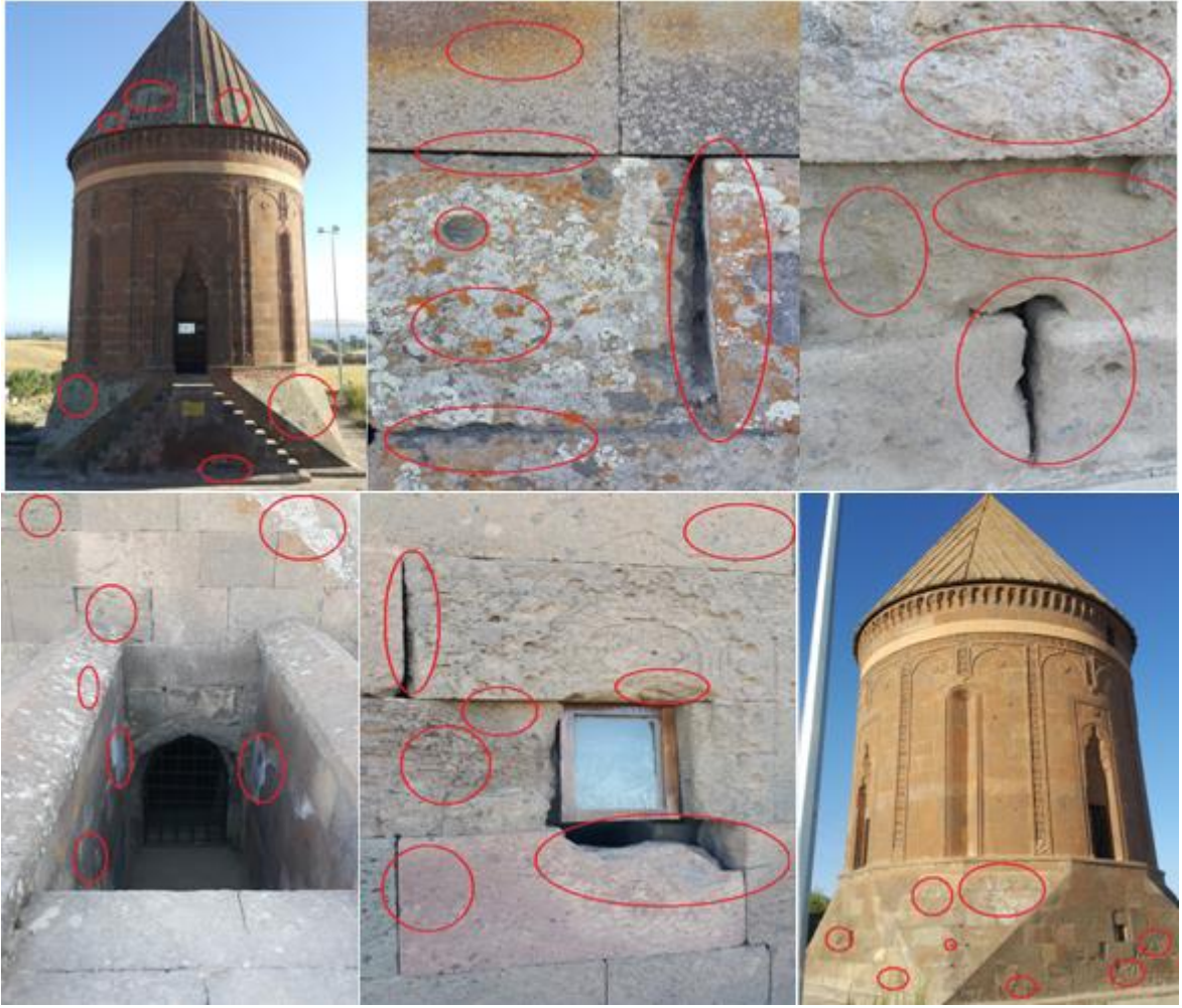
Şekil 4.18. Hasan Padişah Kümbetinde gözlemlenen hasarlar
