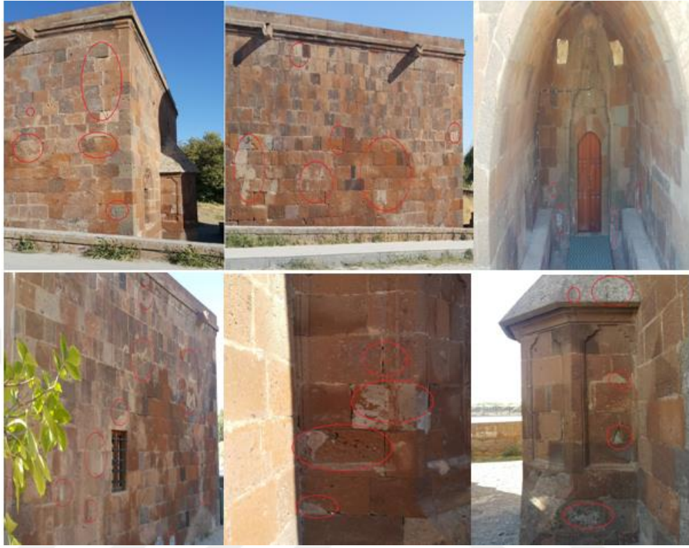
Şekil 4.9. Emir Bayındır Mescidinde gözlemlenen hasarlar
