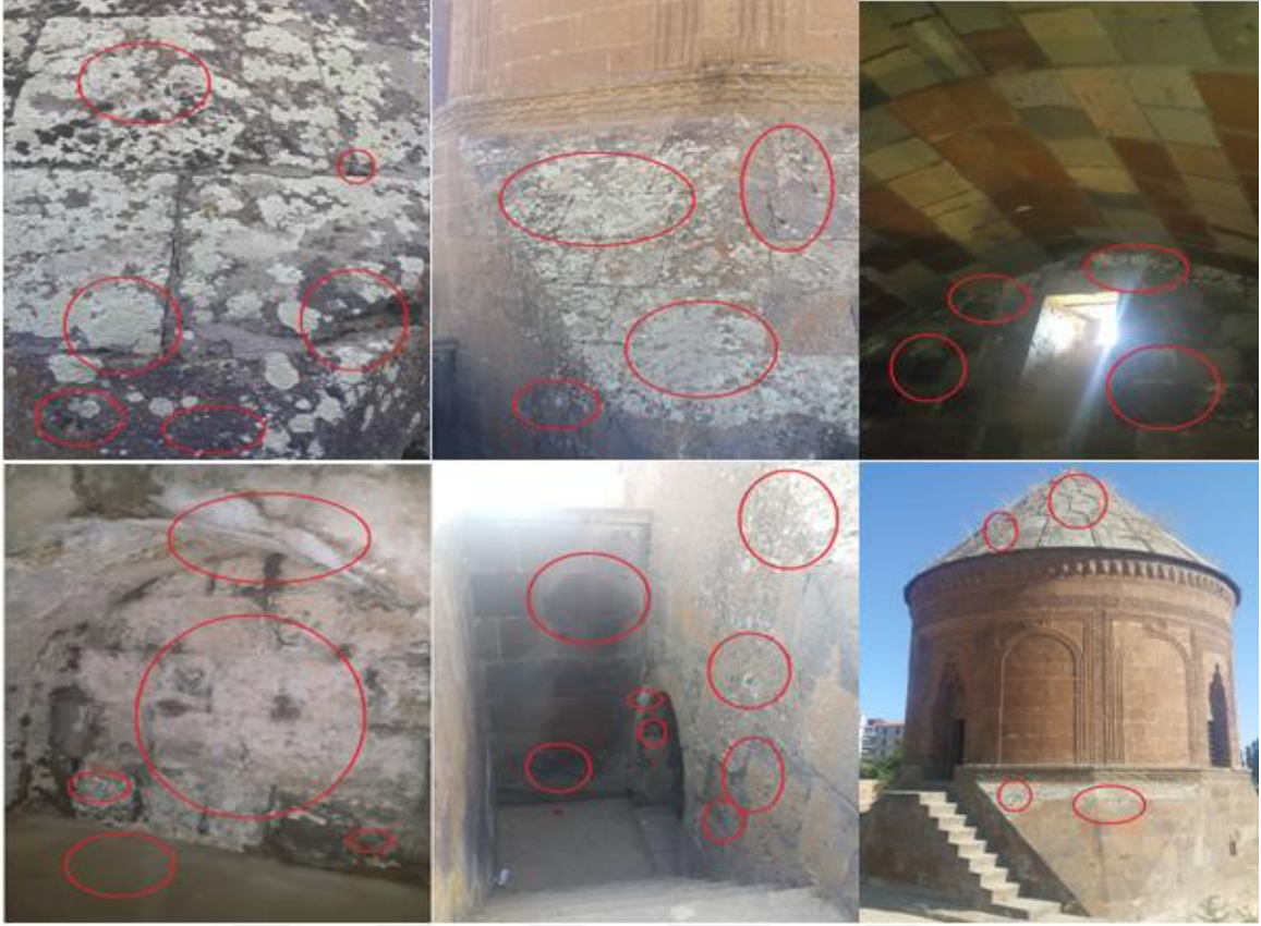
Şekil 4.23. Bugatay Aka - Şirin Hatun Kümbetinde gözlemlenen hasarlar
