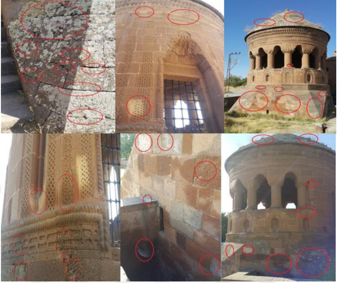
Şekil 4.19. Emir Bayındır Kumbetinde gözlemlenen hasarlar
