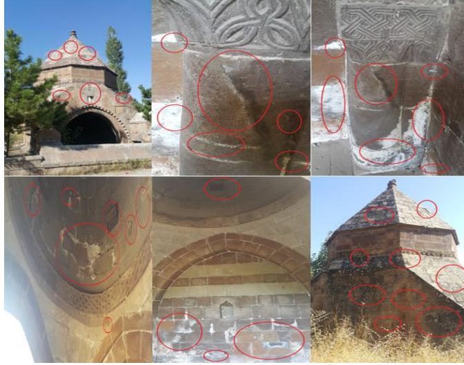
Şekil 4.29. Emir Ali Türbesinde gözlemlenen hasarlar
