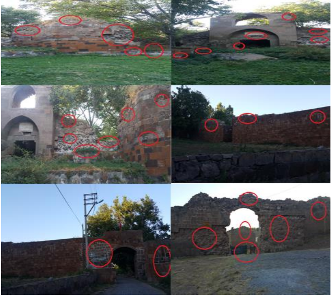
Şekil 4.4. Sahil Kalesinde gözlemlenen hasarlar
