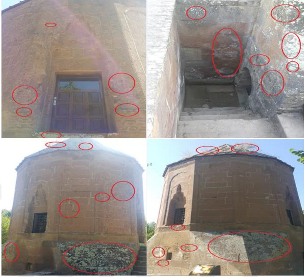
Şekil 4.17. Keşiş Kümbetinde gözlemlenen hasarlar
