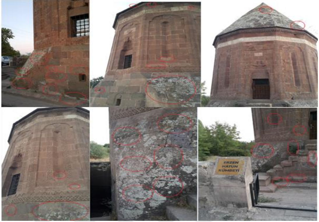
Şekil 4.16. Erzen Hatun Kumbetinde gözlemlenen hasarlar
