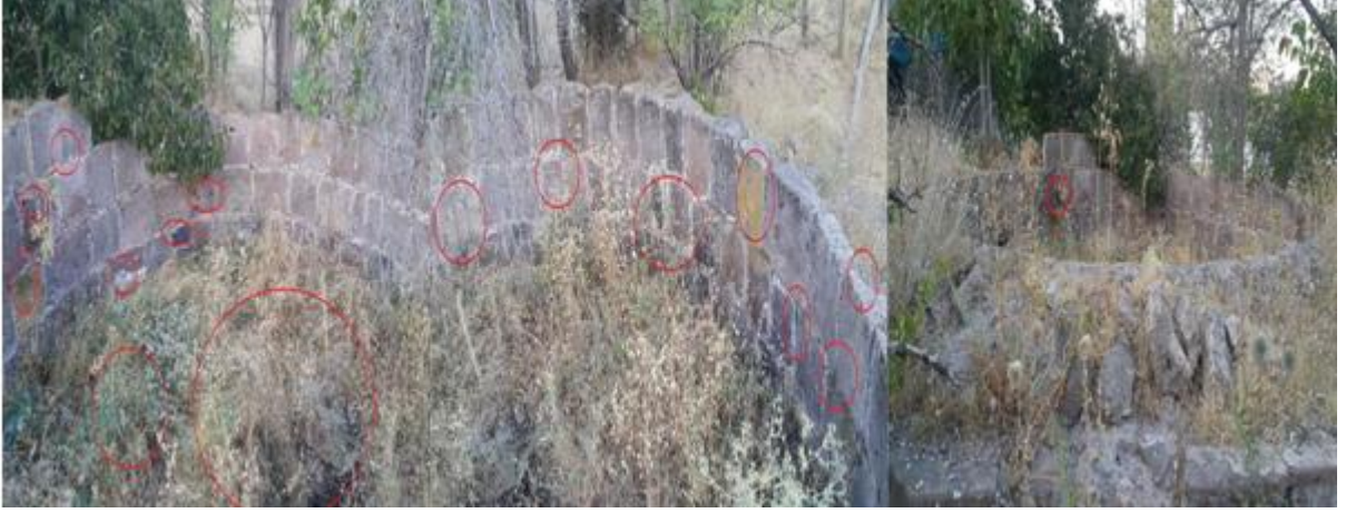
Şekil 4.24. Yeşil Kümbet için gözlemlenen hasarlar
