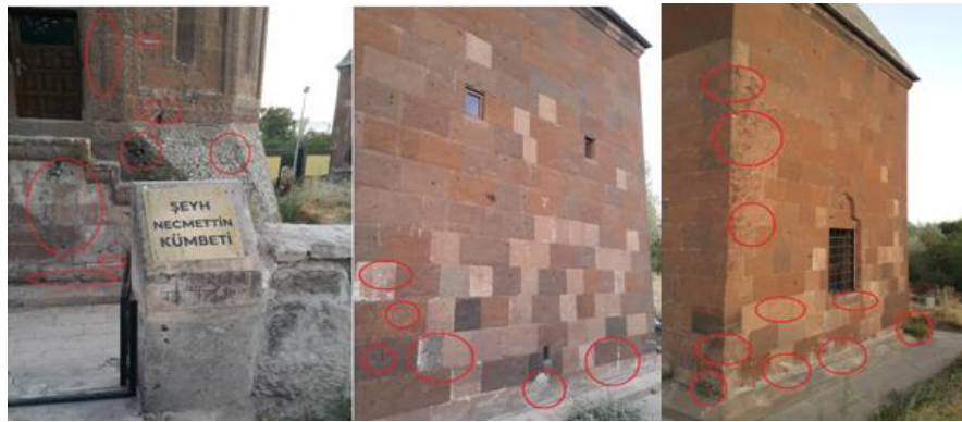
Şekil 4.28. Şeyh Necmettin Türbesinde gözlemlenen hasarlar
