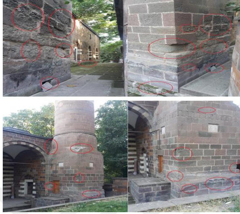
Şekil 4.10. İskender Paşa Camiinde gözlemlenen hasarlar
