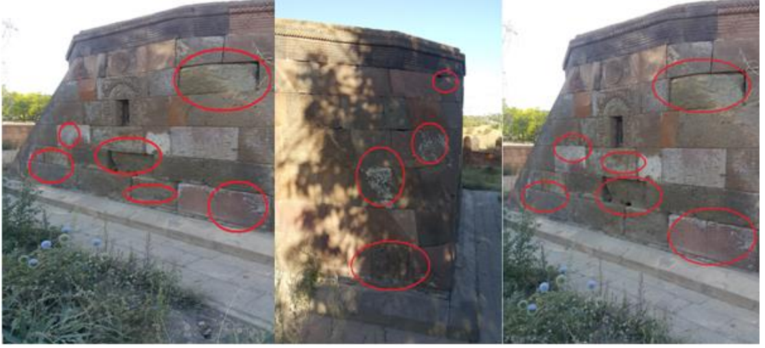
Şekil 4.22. Anonim Kumbet I’de gözlemlenen hasarlar
