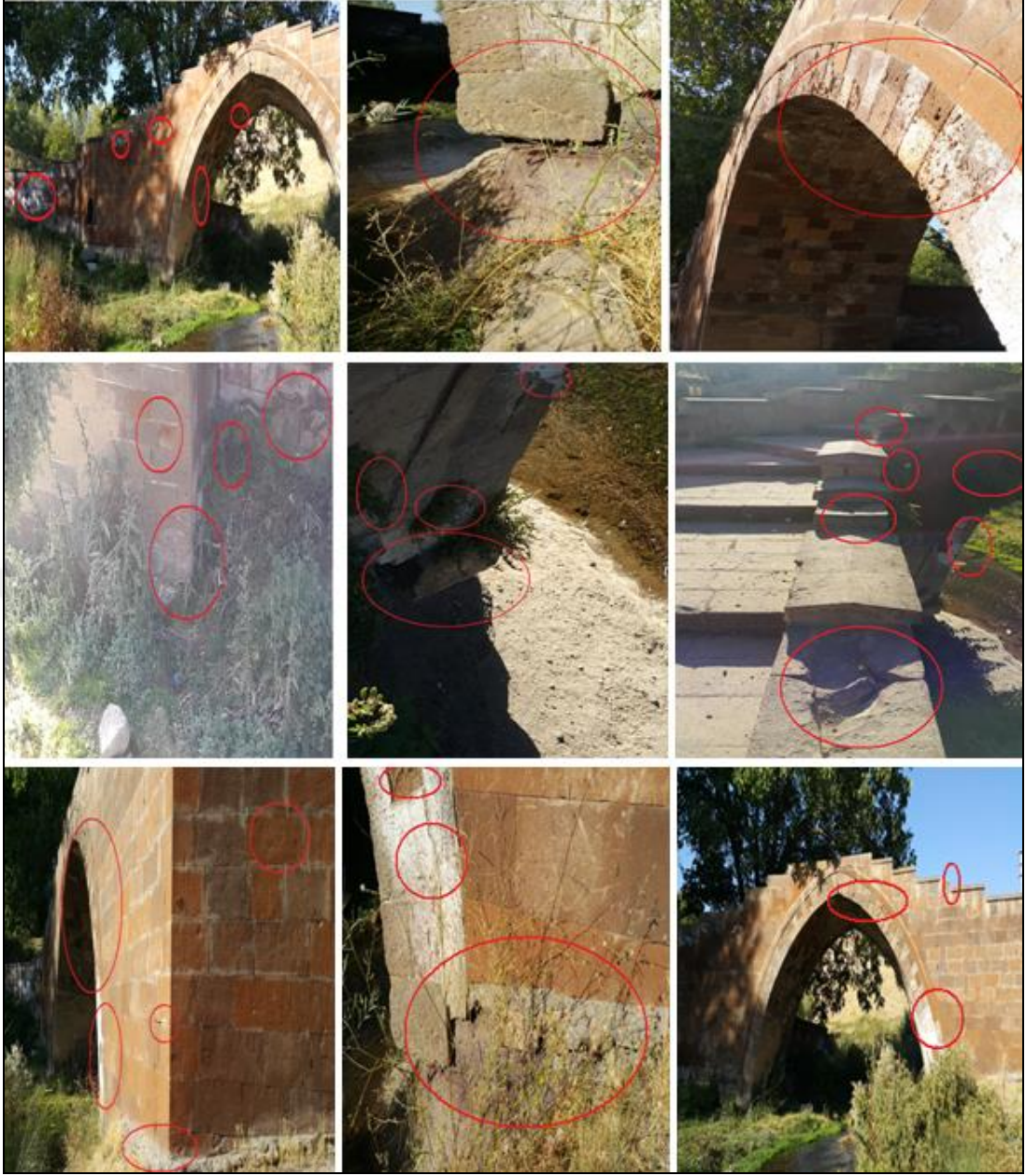
Şekil 4.3. Emir Bayındır Köprüsünde gözlemlenen hasarlar
