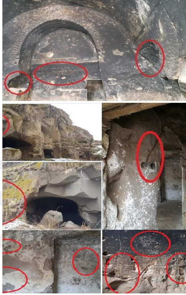
Şekil 4.7. Harabeşehir mağara evlerinde gözlemlenen hasarlar
