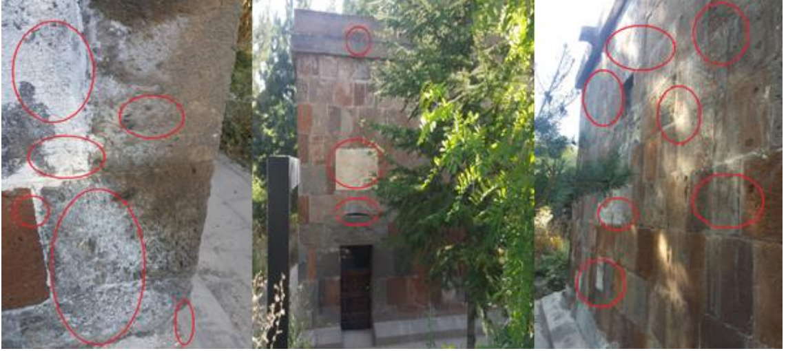
Şekil 4.25. Dede Maksut Türbesinde gözlemlenen hasarlar
