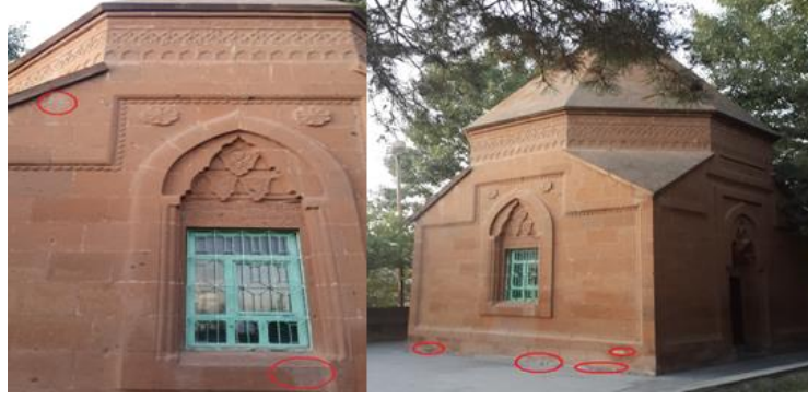
Şekil 4.27. Abdurrahman Gazi Türbesinde gözlemlenen hasarlar
