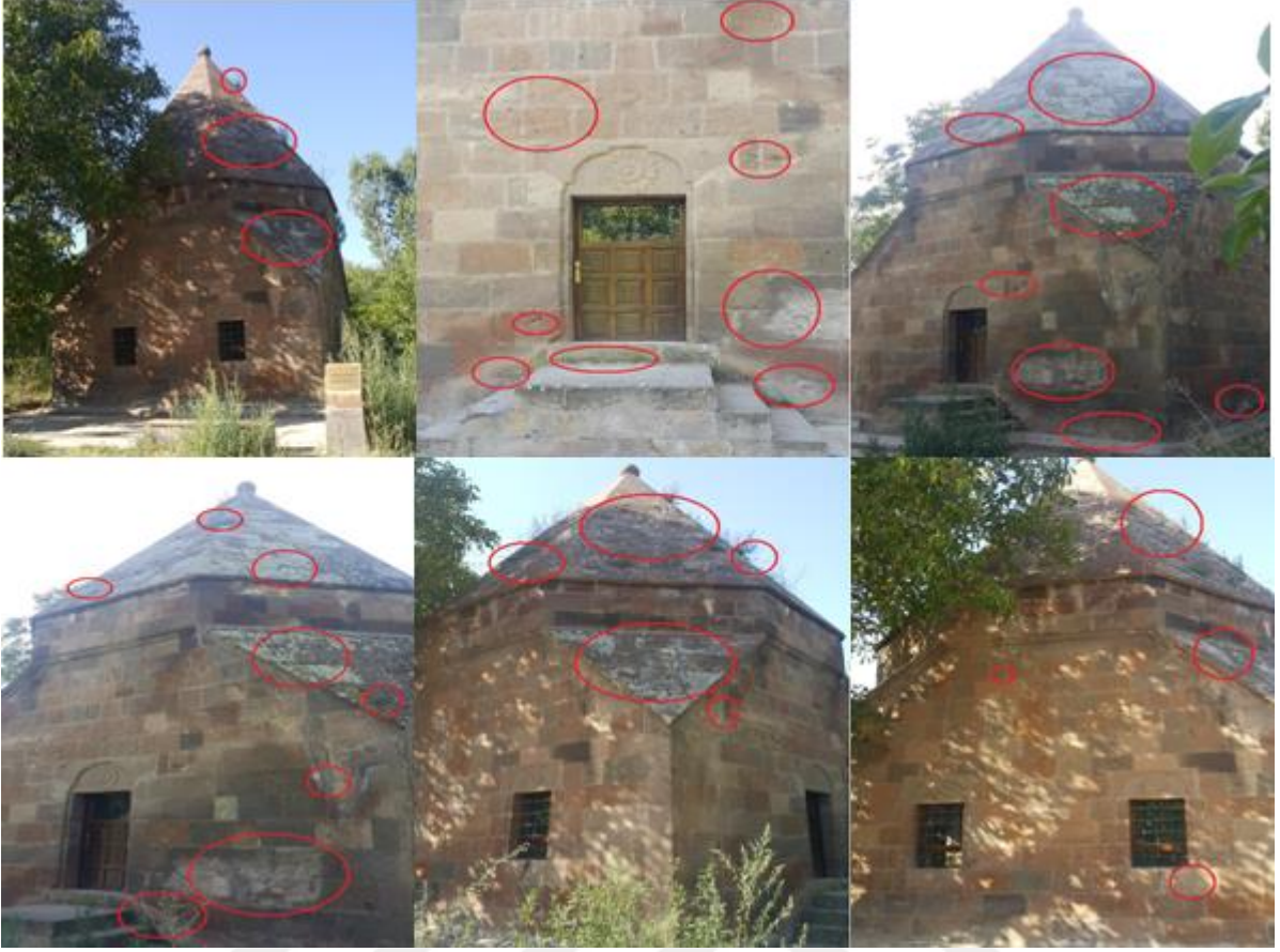
Şekil 4.20. Anonim Kümbet II gözlemlenen hasarlar
