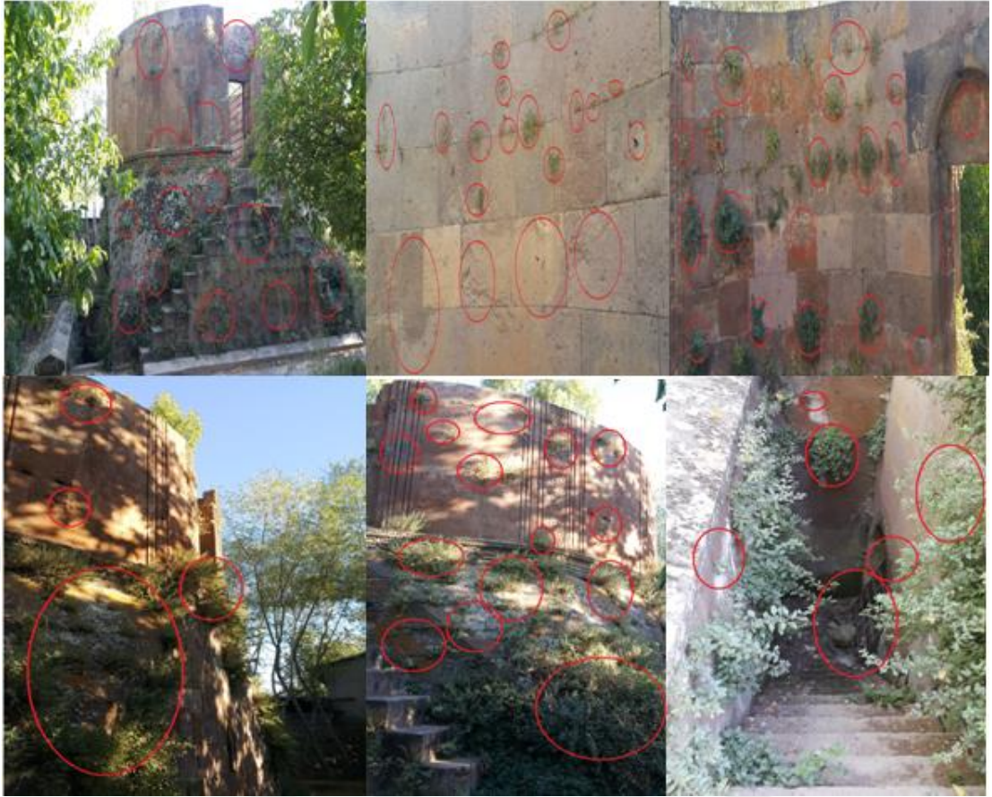
Şekil 4.21. Alimoğlu Hurşit Kumbetinde gözlemlenen hasarlar
